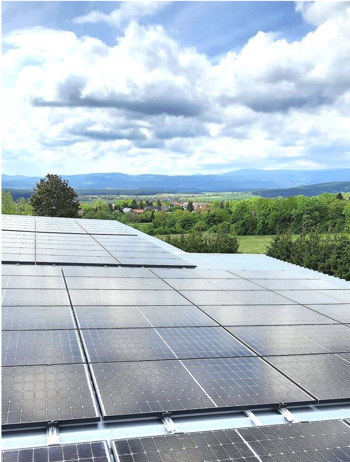
▲ Blick über die im Mai 2021 errichtete PV-Anlage mit einer Leistung von 99 kWp am Dach der Würflacher Wellnesswelt
